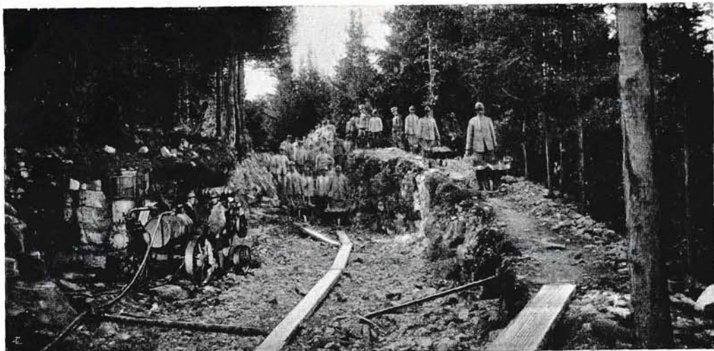
Lo scavo di una trincea sulla strada della Grotta Nera. A sinistra il macchinario per la perforazione delle mine.
