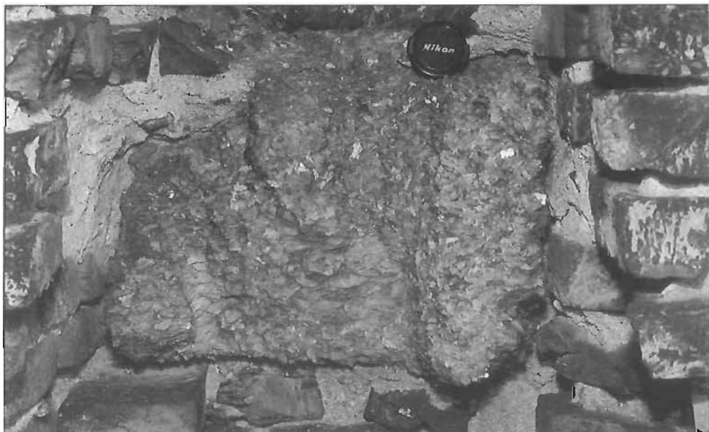
Fig. 10 - Torre Garisenda: docce subverticali dovute al ruscellamento di acqua piovana incanalata lungo le fratture dei mattoni al di sopra del blocco di gesso.
