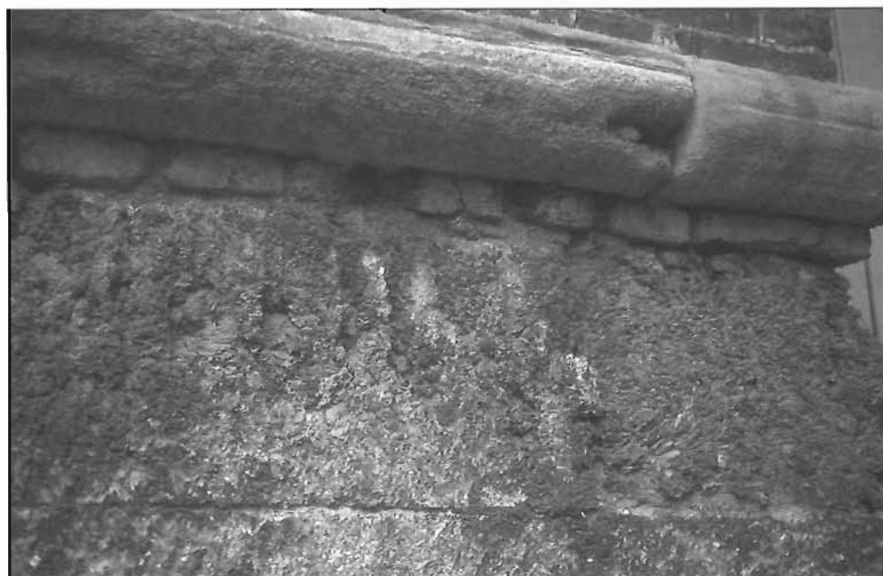
Fig. 1 - Basamento in gesso della torre medioevale di Via Altabella: il lato a destra, mai restaurato evidenzia un abbassamento notevole dei gessi, abbassamento che non può viceversa essere misurato sul lato a sinistra perché i blocchi di gesso originari sono stati sostituiti durante un recente restauro.
