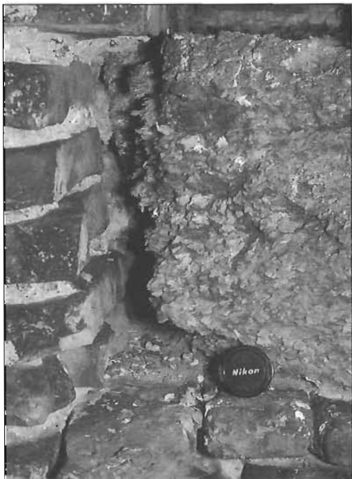
Fig. 11 - Torre Garisenda: cristalli di gesso erosi, residui della dissoluzione del gesso da parte delle acque di condensazione.
