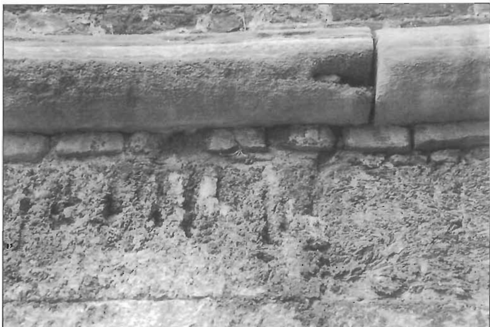
Fig. 6 - I fori da gocciolamento nel gesso protetto dal sottosquadro di arenaria della torre Incoronata.
