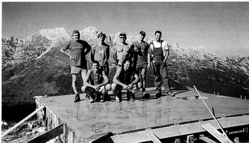
La gettata di calcestruzzo sulla quale verrà montato il nuovo bivacco è terminata (foto G. Vascotto)
